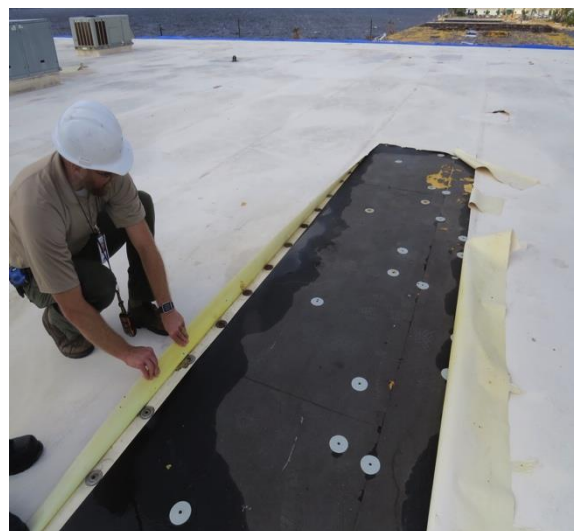
Membrane torn off
